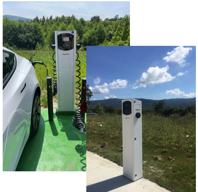
Dos puntos de recarga para automóviles eléctricos
